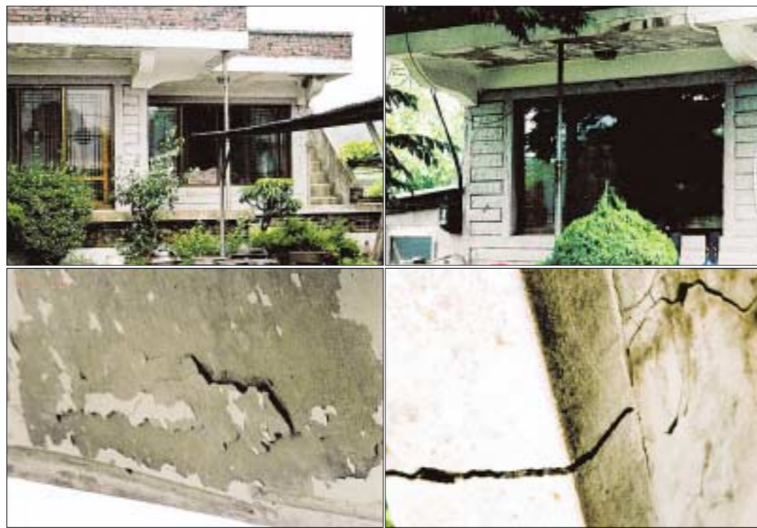
주민대책위원회는 군부대측 주장과 달리 전차포 사격으로 인해 주택 파손 등의 피해가 발생했다고 주장하고 있다. 사진은 주민들이 촬영한 연곡5리 길가주택 주택이다. 전차포 사격으로 건물의 균열이 생기고 붕괴를 방지하기 위해 쇠파이프 보강공사를 했다고 주민들은 설명하고 있다.
