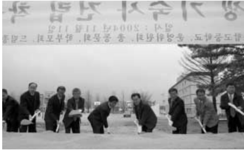
일동종합고등학교는 지난 11일 학생기숙사 건립의 첫삽을 뜨고 내년 5월 준공을 목표로 공사에 들어갔다.
