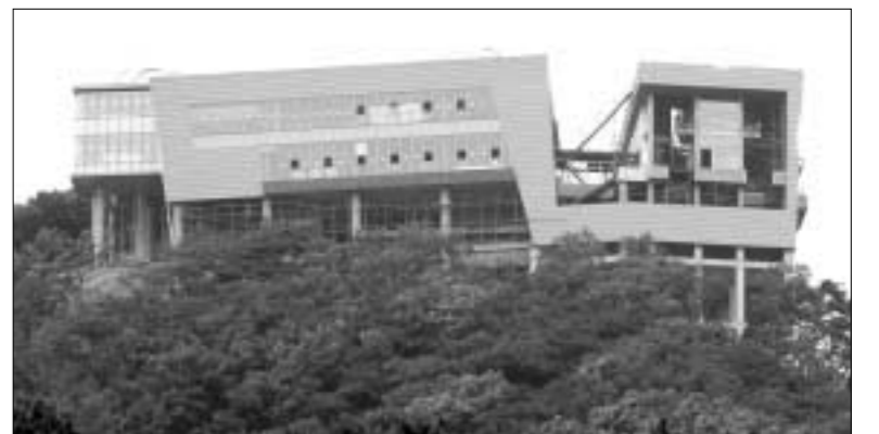
준공 앞둔 장락원천문대 장흥면 석현지 장흥관공지 입구에 국내 최대규모로 건립중인 장락원천문대 가 7월말 준공을 앞두고 공사기 한창이다. 1백여억원의 사업비가 투자돼 건립되는 장락원 천문대에는 최대배를 308배의 대형민사망원경과 슬라이트 돔 그리고 디지털 방식의 최신 천체투영설을 갖추고 있다.
